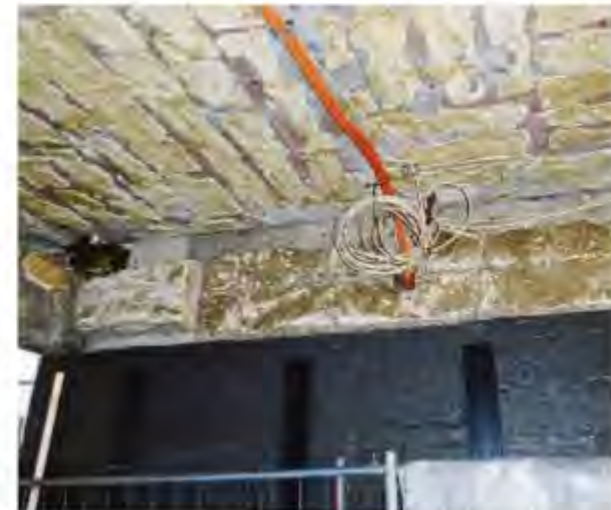
Kabel hängen von den Decken des Altbaus der KSS.
