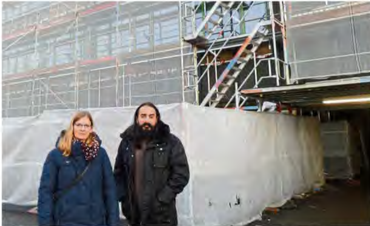
Die Schulelternbeiratsvorsitzende Isabele Theis und ihr Stellvertreter Kemal Kilic beklagen den schleppenden Baufortschritt bei der Sanierung des Altbaus der Karbener Kurt-Schumacher-Schule.
